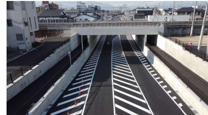
工事名 都市計画道路築造工事（H31宝二丁目北新線：第2工区）
